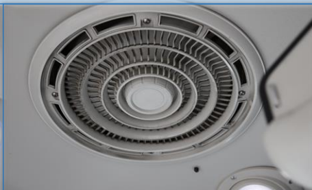
換気装置による換気（路線）
